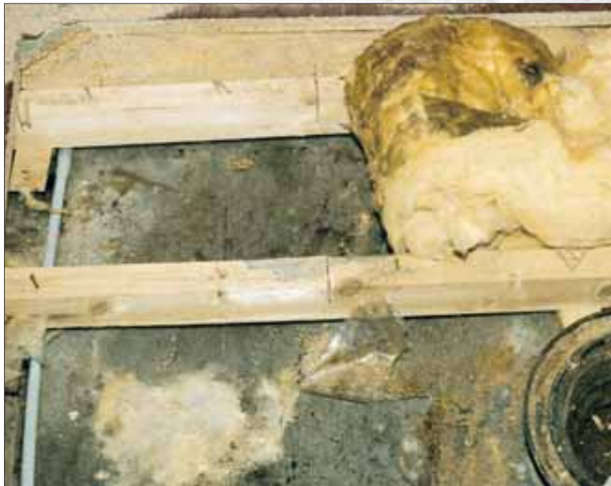
Fukt fra grunnen har trengt gjennom betongen/plastfolien, og ført til muggdannelse
